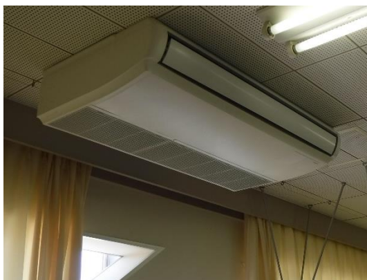
教室に設置されたエアコン
